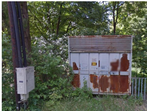
4103-as sz. lemezházaz 10/0,4 kV-os transzformátor
