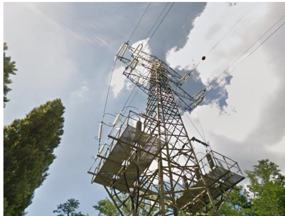
ELMŰ 120 kV-os légvezeték hálózat kábelfejes oszlopa
